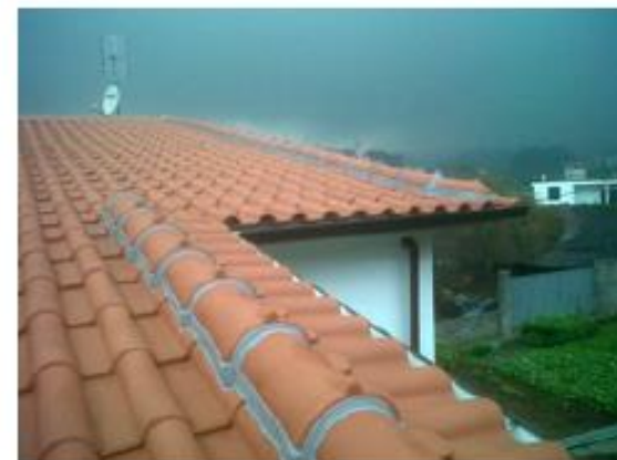
Excesso de argamassa em rincão.
