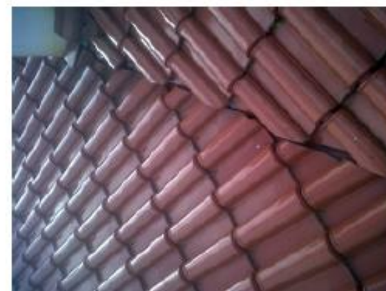
Sobreposição incorreta do rufo.
