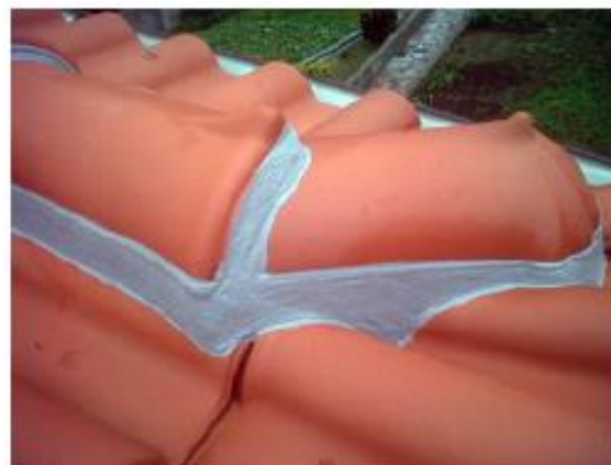
Excesso de argamassa de fixação.
