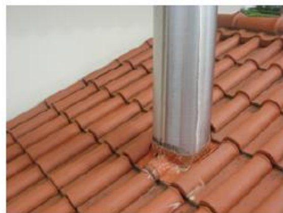
Remate de chaminé mal executado.
