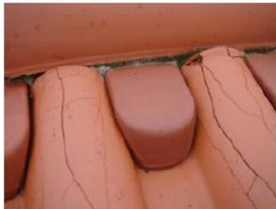
Lascas, fissuras e fendas em telhas cerâmicas.
